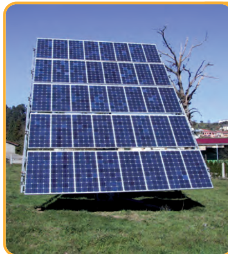
Fotografía Paneles solares con seguimiento.
